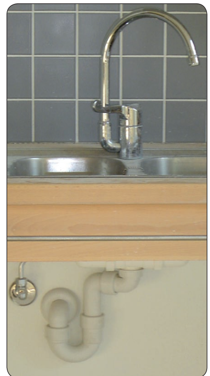
Robinet à levier et en col de cygne et siphon déporté.
