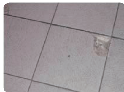
Un revêtement de sol endommagé accroît le risque de trébuchement.
